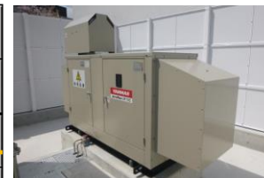
【大東市上下水道局 自家発電設備】
