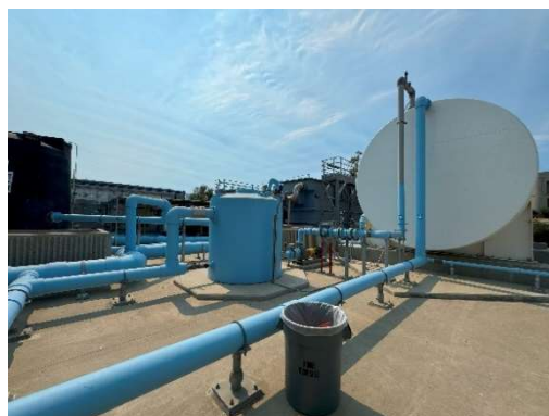
オゾン処理+活性炭処理
