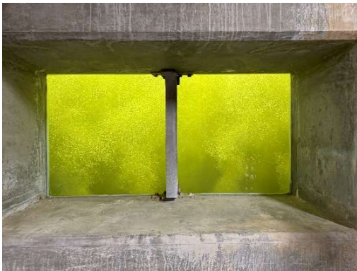
オゾン接触池
