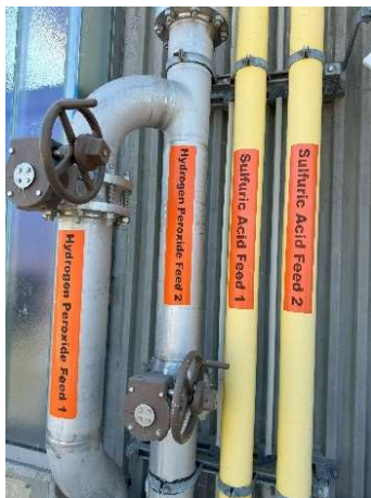
オゾン施設薬品注入管
