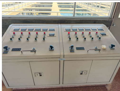
ろ過池現場操作盤
