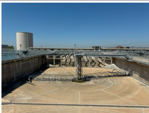
干池中の沈でん池
