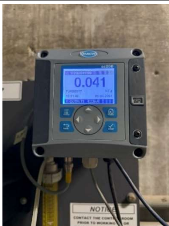
ろ過水濁度計（単位NTU）
