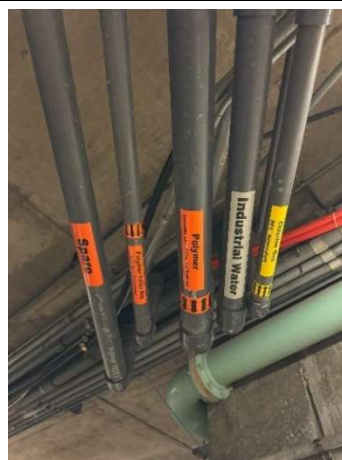
薬品等配管（スぺアもみられる）
